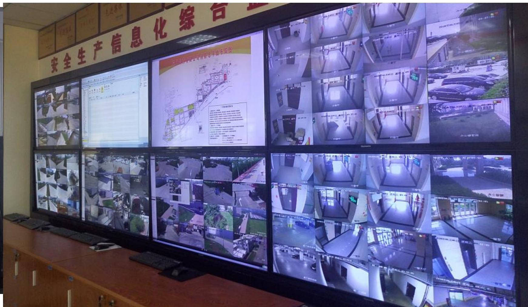
山东瑞阳制药有限公司消防监控平台
